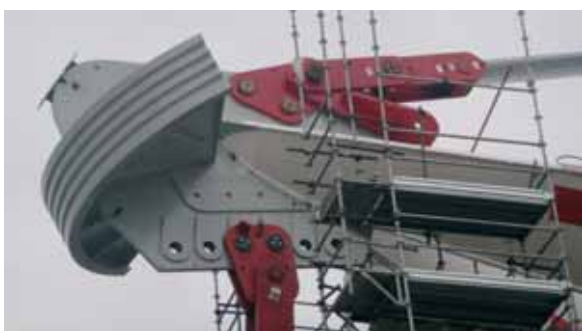
Fig. 37 - Dettaglio del nodo di sommità del pilone in cui si notano i dispositivi provvisori per il sollevamento
